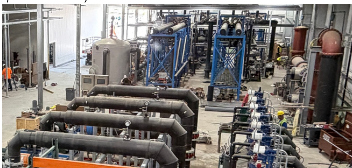
Los sistemas avanzados de filtración tratarán el agua del río Columbia para su uso en los parques industriales del Port.
